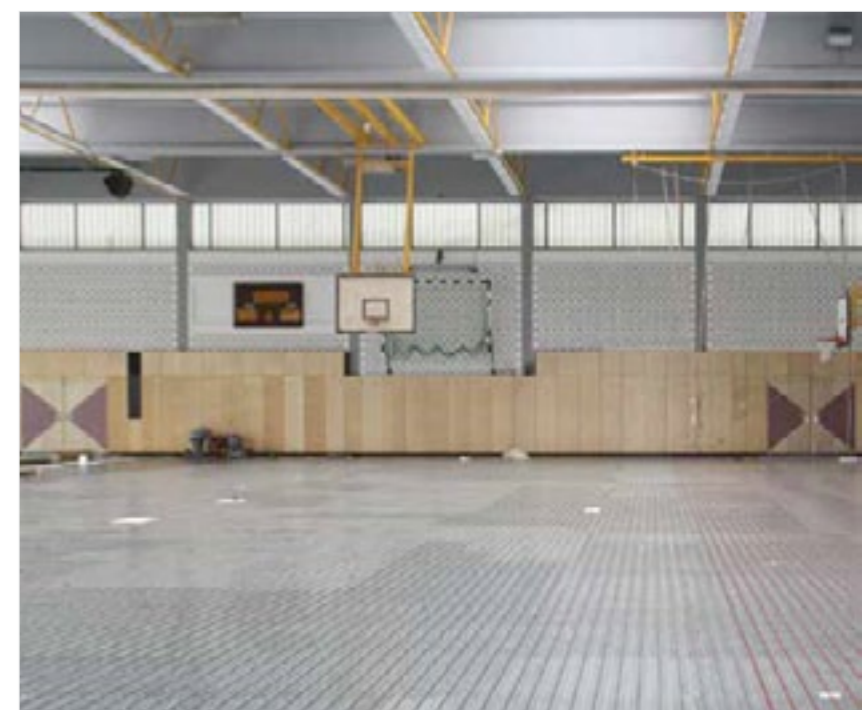
System ogrzewania podłogowego Roth w hali sportowej
